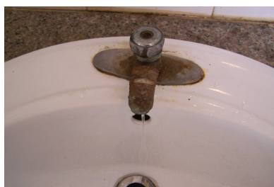
锈化的水龙头漏水
