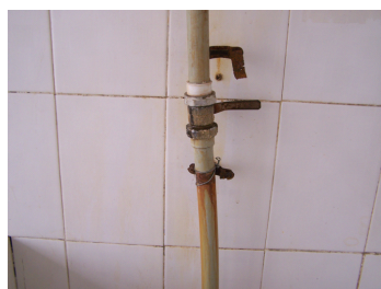
老化的水管漏水
