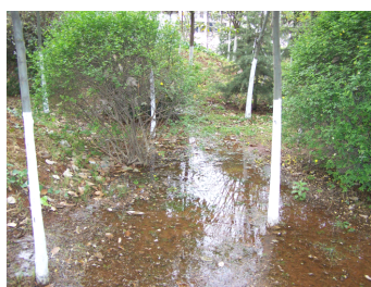
自来水管漏水
