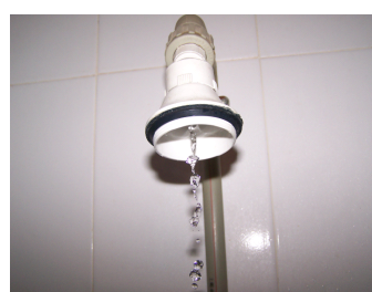
洗浴的龙头漏水
